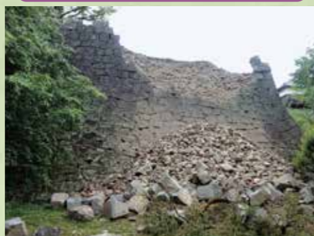
被災後：石垣の崩落（2016年4月20日）
