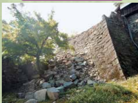
被災後：石垣の崩落（2016年4月20日）
