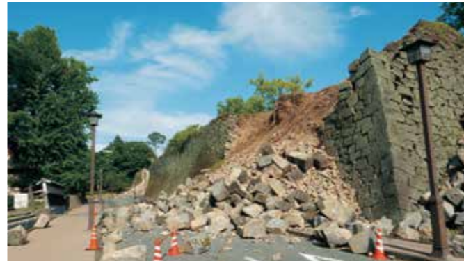
⑥百間石垣 3ヶ所で崩落、石材が市道をふさぐ
