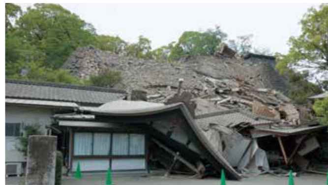
⑤東十八間櫓 石垣崩壊による櫓倒壊
