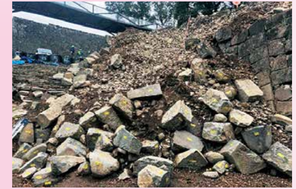
崩落した石材(令和4年1月)
