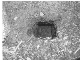
煙道(出口/方形)
