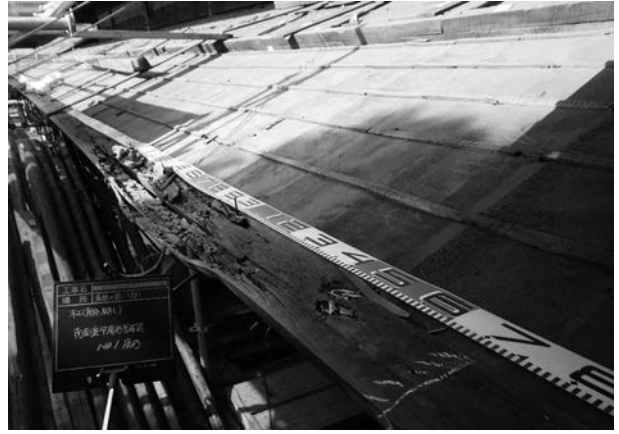
写真 4 - 23 南面裏甲腐朽確認状況
