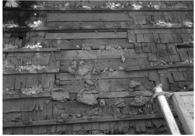
写真 2-5 北面野地板 既往の改修の痕跡
