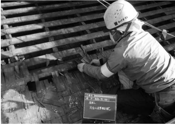
写真 4 - 19 土居葺き撤去状況
