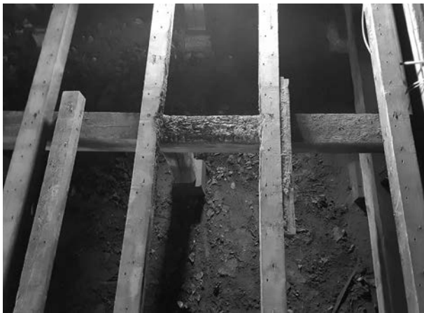
写真 2 - 11 小規模な火災の痕跡
