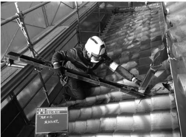
写真 2-3 桶取り外し時の腐食確認状況
