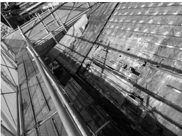
写真 2-4 南面野地板 既往の改修の痕跡
