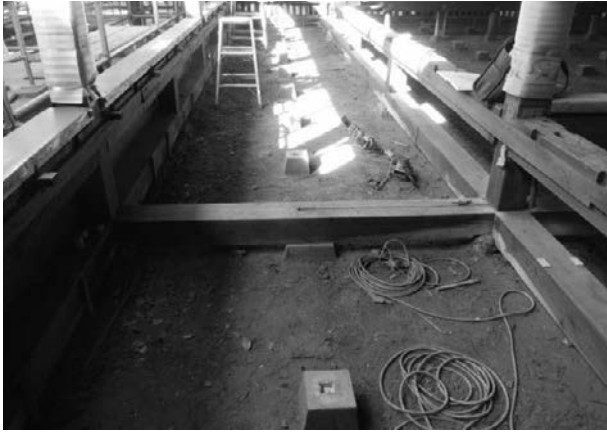
写真 2 - 32 設計図には記載のない敷土台
