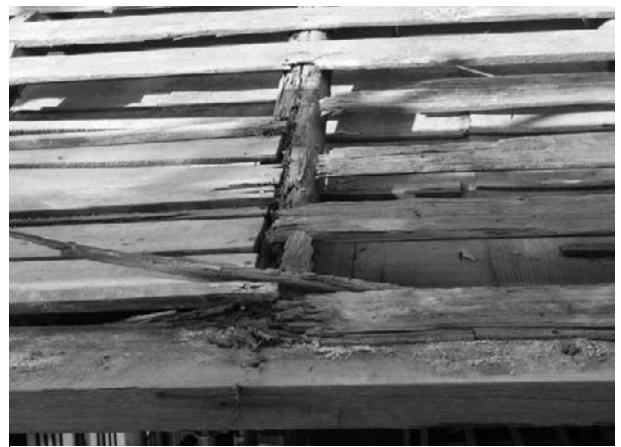
写真 2-7 既設裏甲腐食状況
