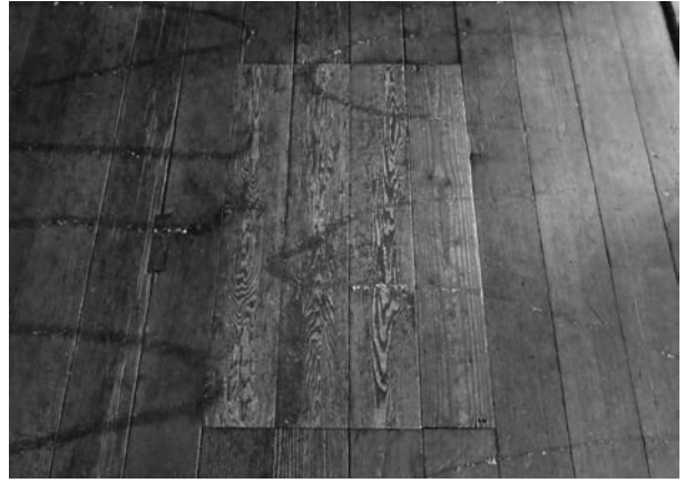
写真 2 - 36 火災痕上の床板
