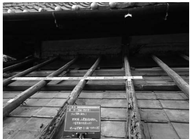
写真 2-8 既設野垂木腐食状況
