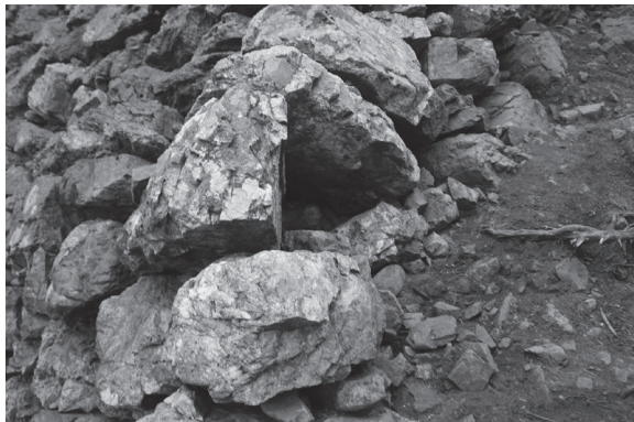
図23 補修箇所1（補修前）（北西から）
