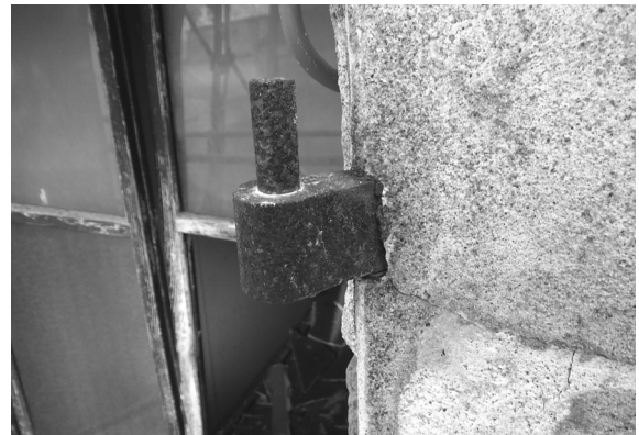
解体工事 38 鉄扉蝶番の痕跡（南面2階・東窓）
