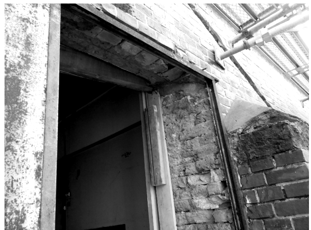
写真 3-5 後年の開口部・拡大（外壁西面2階）
