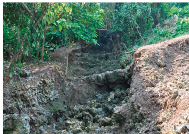
写真11 岸の石積と河床のはつり(?)
