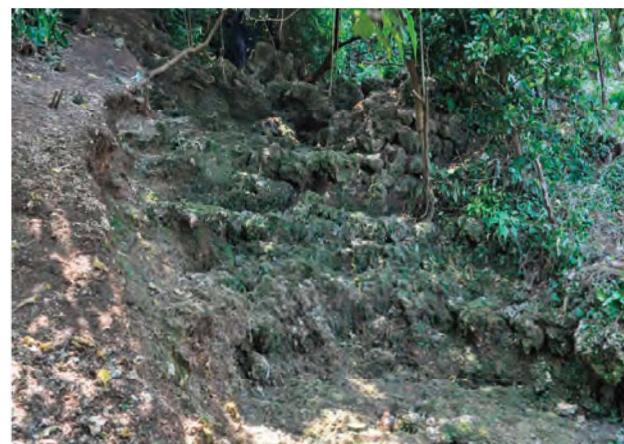
写真12 岸の石積と河床の段差
