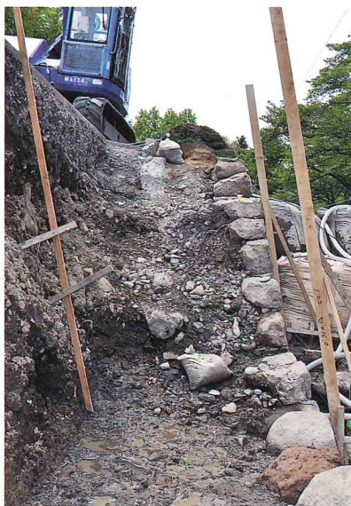
外側 1-1-2 (崩壊部南側) コンクリート壁を含む裏込め
