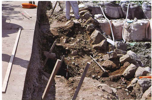
⑥崩壊部裏込め土層断面 (北から)
