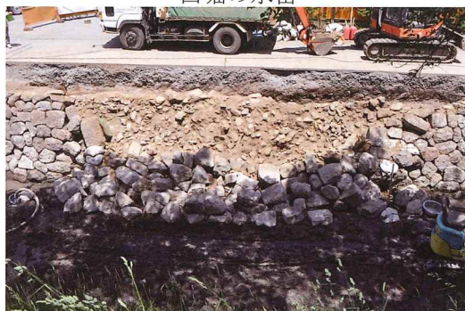
崩壊土除去状況
