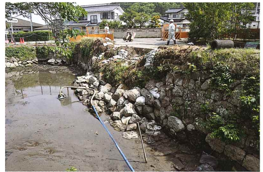
石垣崩壊状況（南西より）
