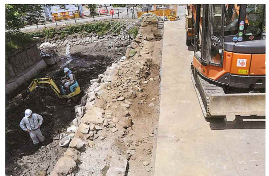
崩壊部裏込め検出（南より）
