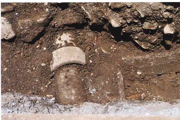
⑦崩壊部裏込めに入るヒューム管・U字溝 (北から)
