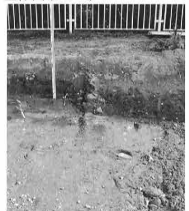
建物建設範囲堆積状況
