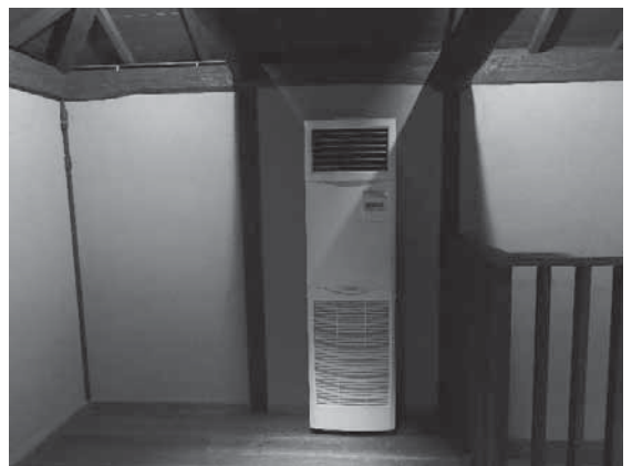
写真 4-102 空調設備、二階展示室の室内機
