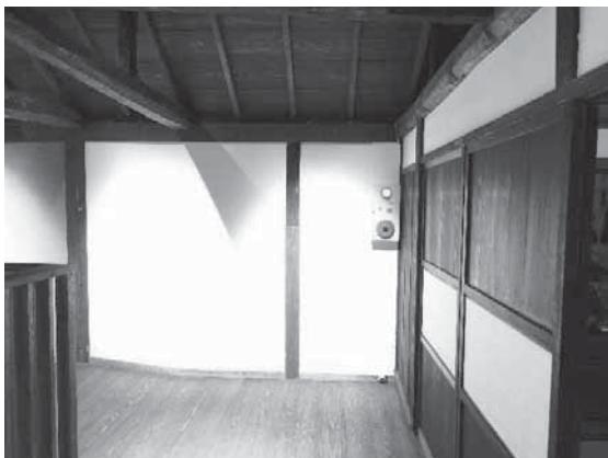
写真 4-100 火災報知設備、二階展示室
