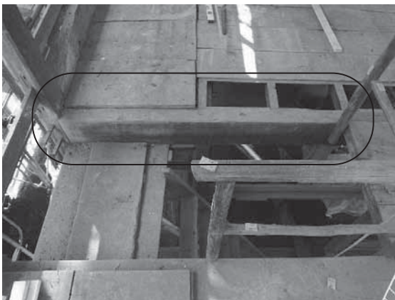
写真 3-30 修理前の階段位置の床梁
