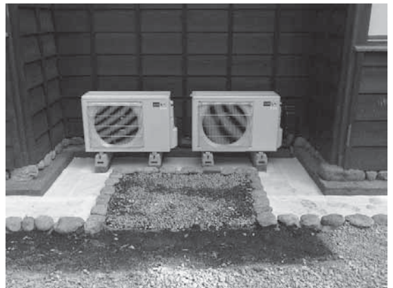
写真 4-103 空調設備、室外機
