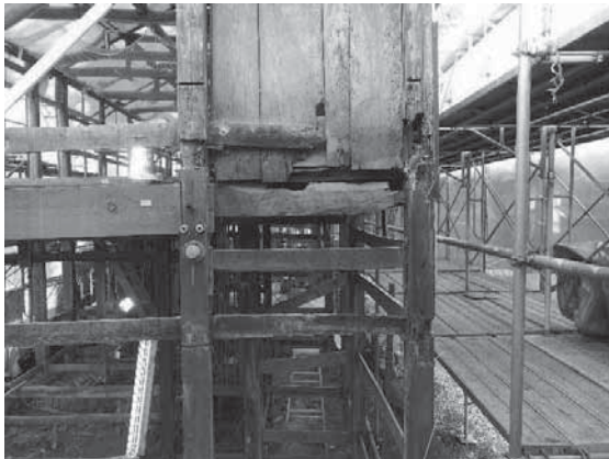
写真3-3 軸部：便所の屋根に接する柱（いー十五通り）
