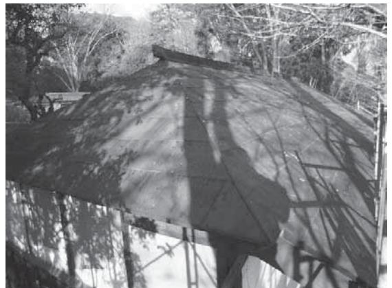
写真 3-52 修理前の屋根
