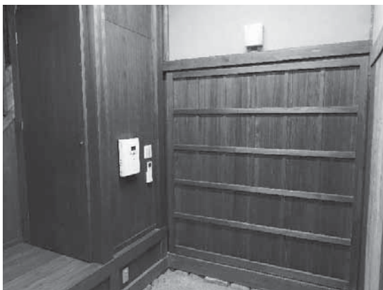
写真 4-99 非常用照明、一階管理スペース
