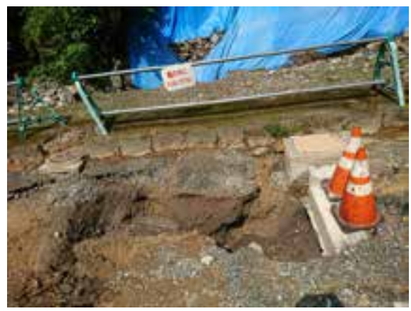
被害状況 東から
