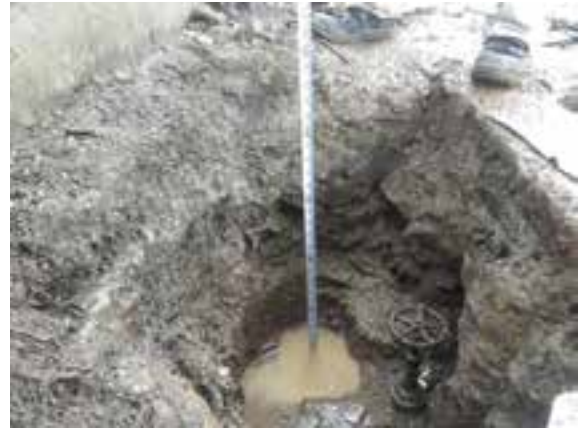
漏水箇所 東から
