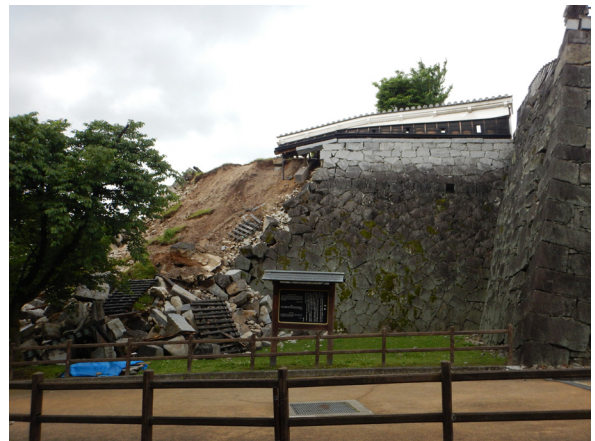
奉行丸 H9 面 石垣・塀崩落状況（東から）
