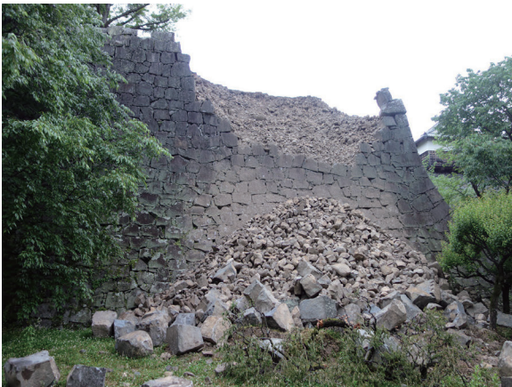
数寄屋丸 H323（東側）被災状況（南西から）
