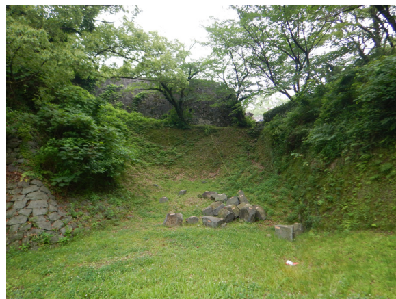
数寄屋丸 H307 崩落石材 (西から)
