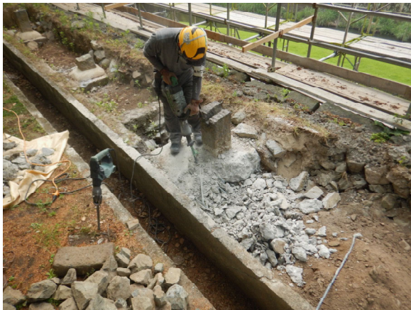
工事①施工状況 掘方整形 既存コンクリート基礎破碎
