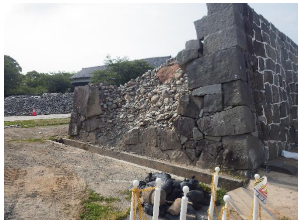
西大手門 40 被災状況(北西から)
