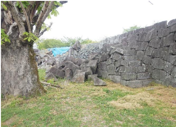
奉行丸 H34・35 被災状況 (南東から)
