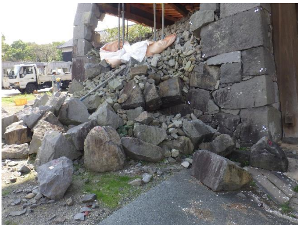
西大手門 40 被災状況(北西から)
