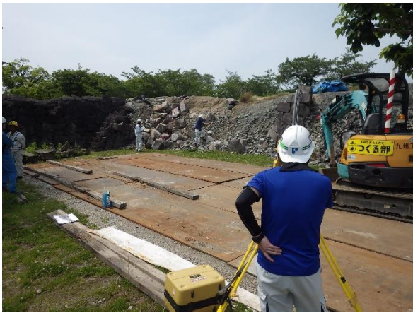
崩落石材測量状況
