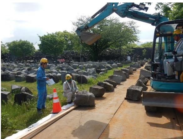
崩落石材記録状況
