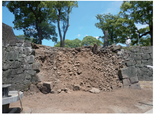
東竹之丸 H214 崩落石材回収後（西から）
