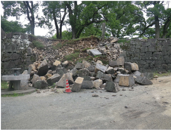
東竹之丸 H214 被災状況（西から）
