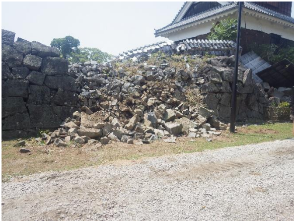
西出丸 H81 被災状況(東から)
