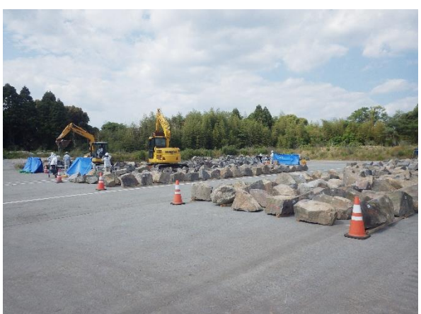
崩落石材管理状況
