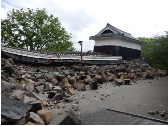
西大手 H42 被災状況(北東から)
