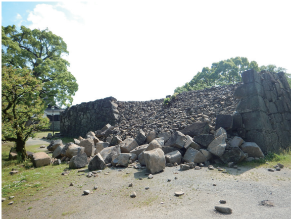
飯田丸 H258 被災状況（北東から）
