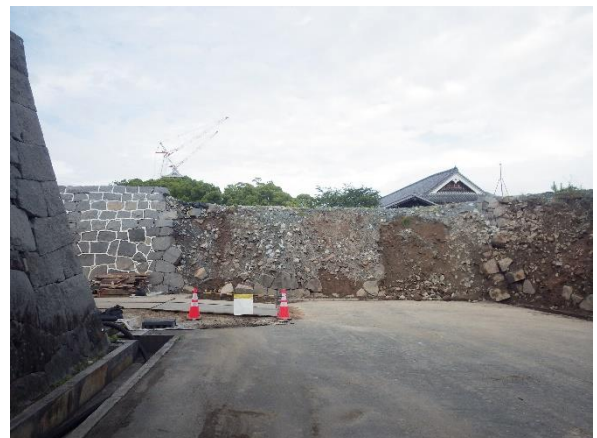
西大手門 H41 被災状況(西から)
