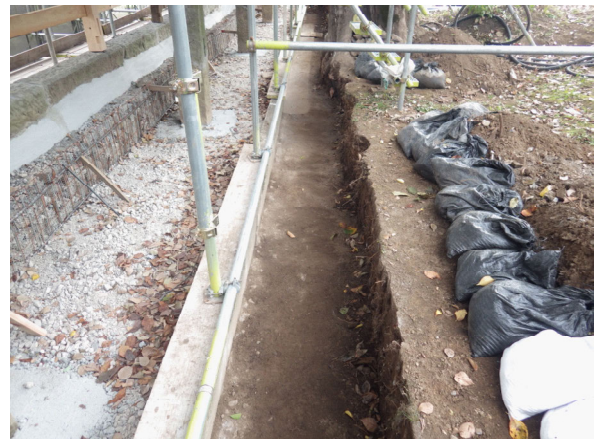
工事⑥施工状況 対象地中央付近掘削等完了後（東から）
