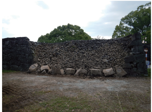
飯田丸 H258 崩落石材回収後（北東から）
