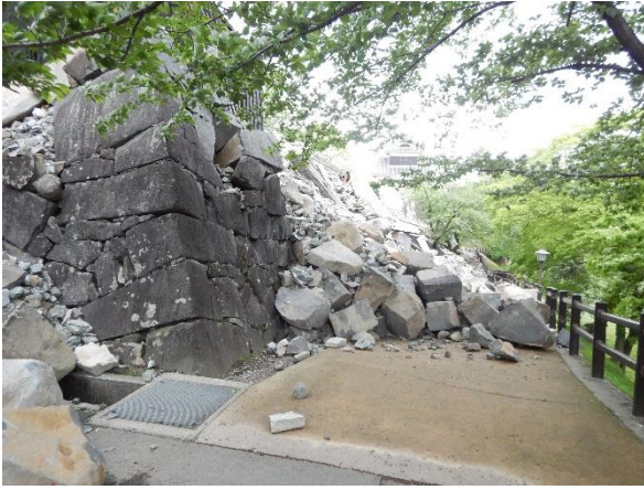
西大手門 H3 被災状況 (北から)
