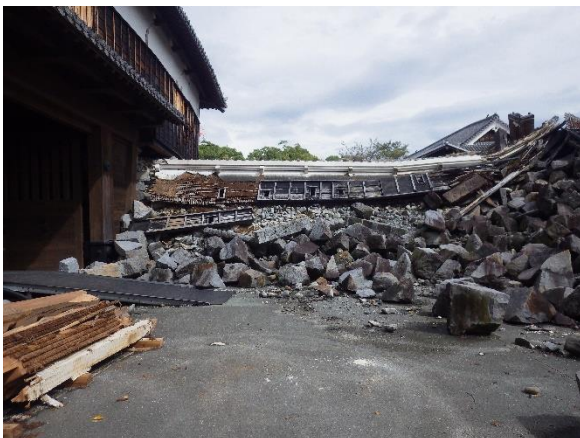
西大手門 H41 被災状況(西から)
