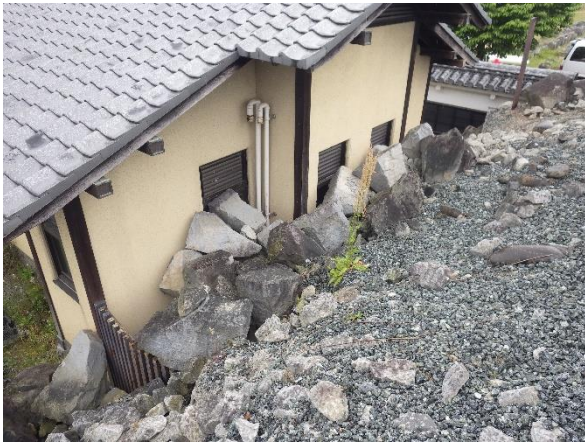
H39 トイレ裏被災状況(北西から)
