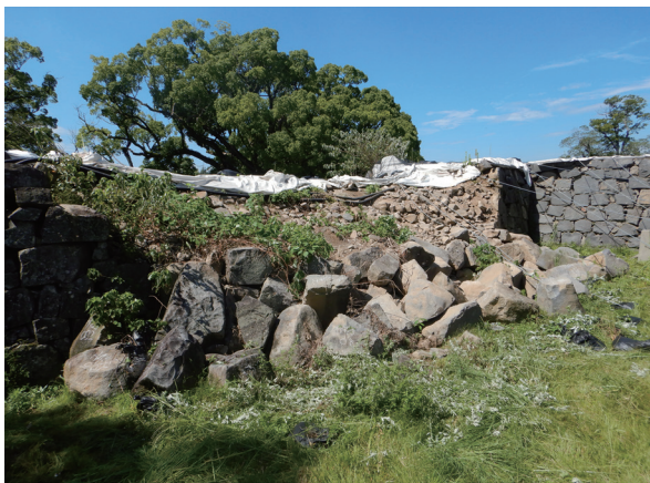
回収前崩落状況
