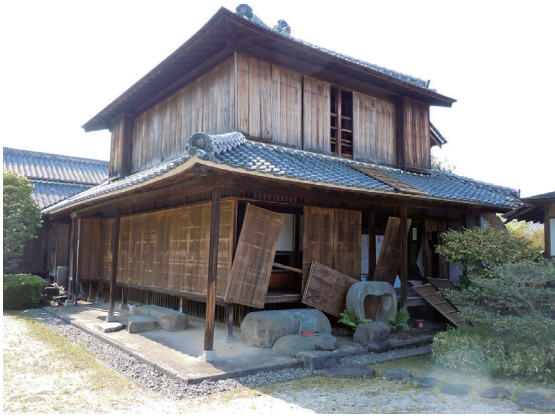
主屋被災状況
