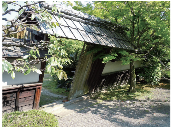
露地門被災状況
