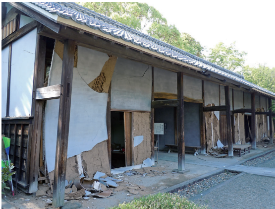
長屋門内側被災状況
