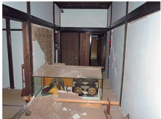
内部被災状況 その2
