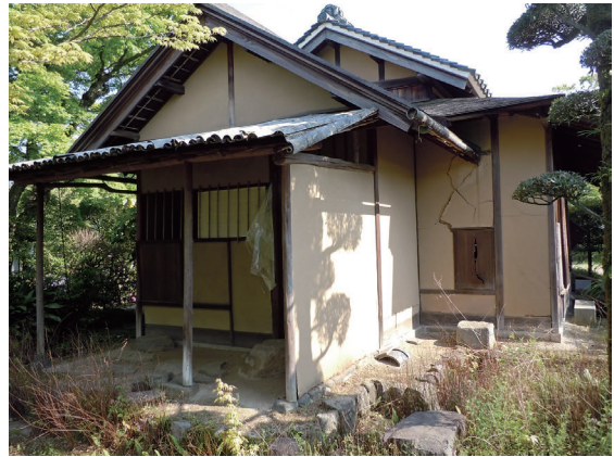
茶室被災状況
