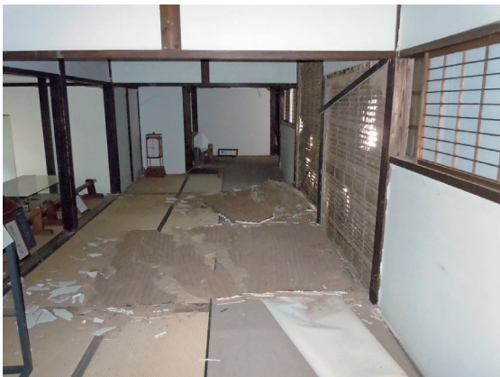
内部被災状況 その1
