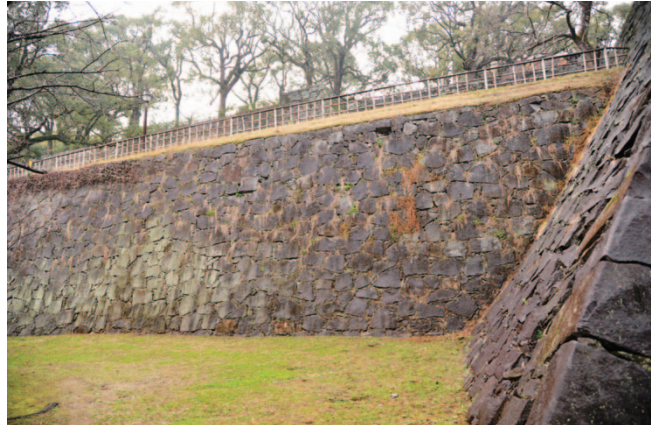
修理箇所現況
