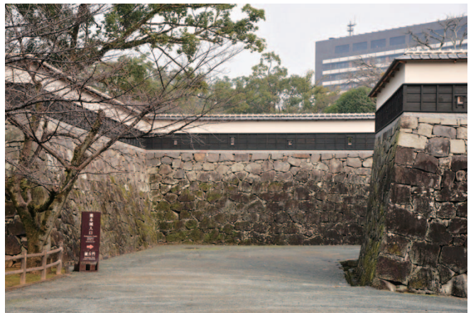
修理箇所現況
