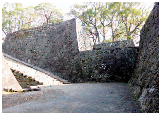
修理箇所現況
