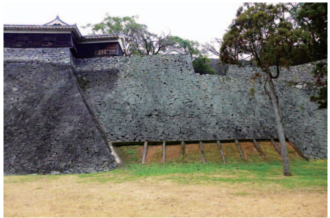
修理箇所現況
