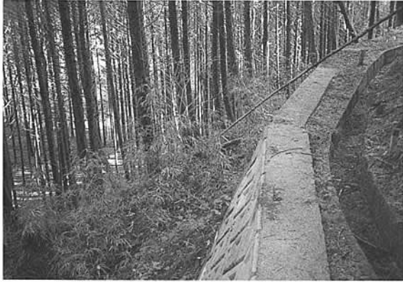
32 山腹急崖をいく高州井手の水路。崩壊が多いため、コンクリートになっている部分が多い。
