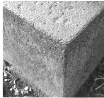
写真13 隅角部面取 (6代利與墓縁石)
