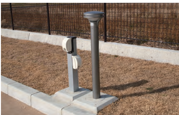
写 5-57 庭園灯と屋外コンセント
