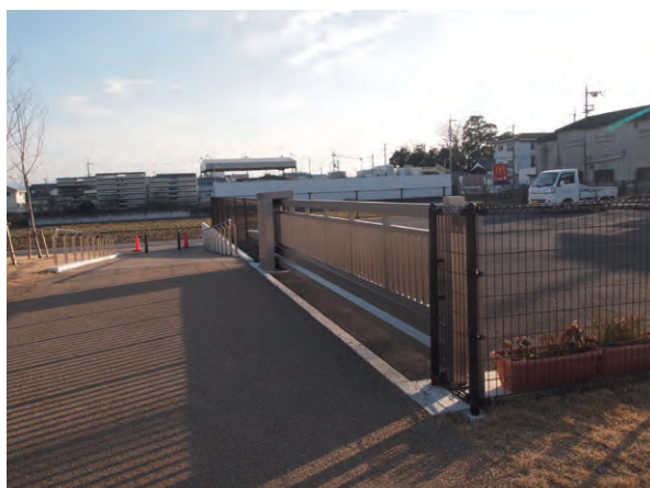
写 5-45 倉庫周りの進入防止柵
