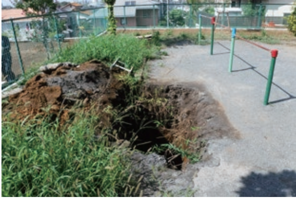
写真81 調査前陥没状況（東から）
