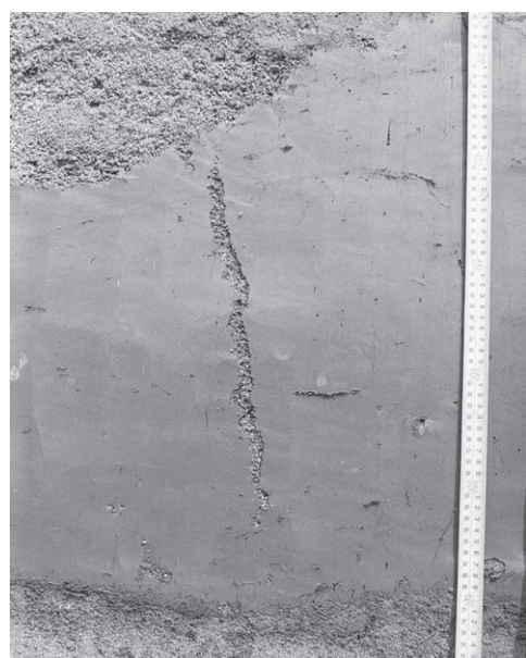
写真3 第13-4層上面の亀裂痕
