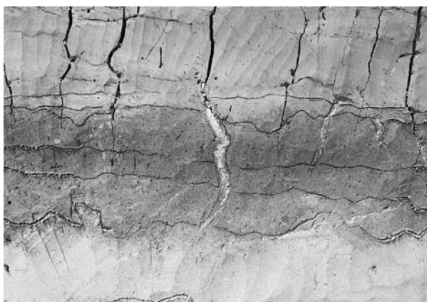
写真 27 土層断面の噴砂
