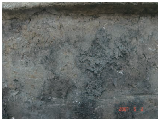
OSF356 頸部外側煤付着状態
