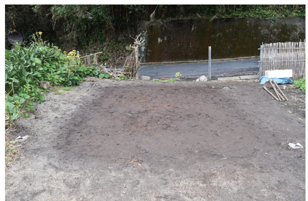
図47 第3地点1トレンチ埋め戻し完了状況(北東から) 原状に復した。
