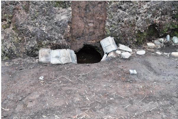
図57 第3地点2トレンチ埋め戻し完了状況 (北東から) 原状に復した。
