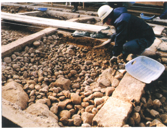
長屋門 石垣裏込め
