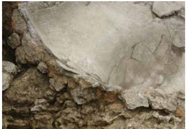
5. 溜池2モルタル破損部断面（トレンチ8、北から）
