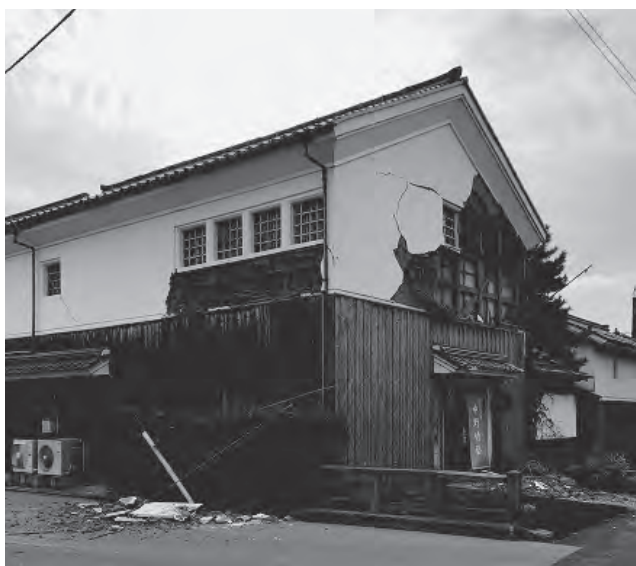
図1 伝統的建造物群の被害状況
