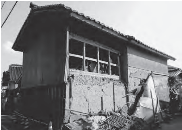
図5 壁の崩落した土蔵
