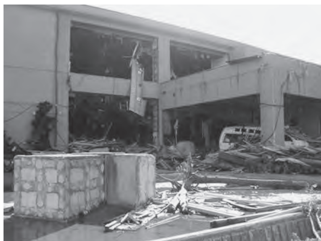
図2 市博被災状況（市博前館長本多文人先生提供）。津波進行方向と逆向きの正面玄関被災状況。引き波でガラスは破壊され、繰り返す津波で資料が流出。内部に残った資料は、津波の濁水とその強い水圧を受けた。
