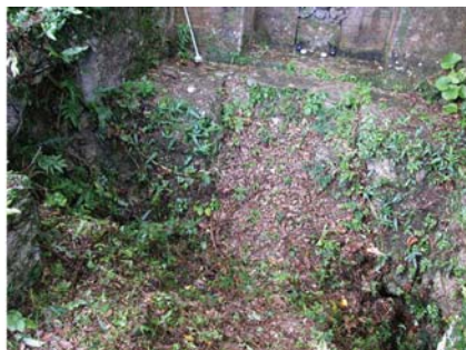
同 陥没状況（第4図-29墓庭）
