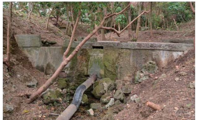
コンクリート製集水タンクと管路
