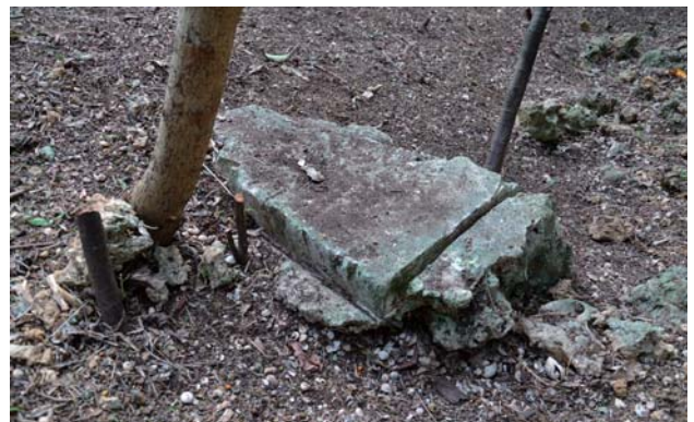
イシジャー右岸下流 コンクリート片
