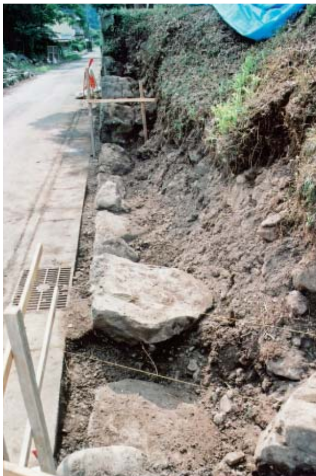
南側石垣の残存状況 (東側部分)
