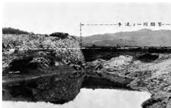
写真19 室戸台風で被災した一の荒手と 下流側巻石(文5より)
