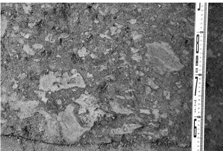
3 越流堤西壁断面 土砂堆積状況 (東から)
