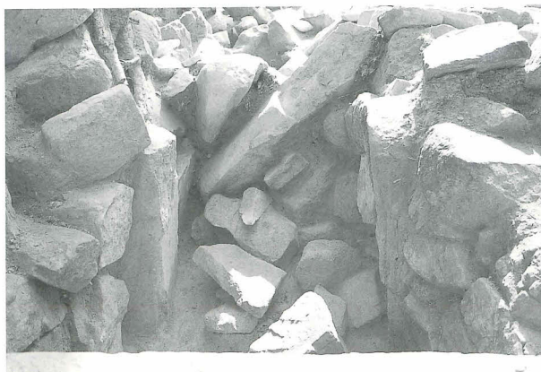
横穴式石室玄門石材崩落状況
