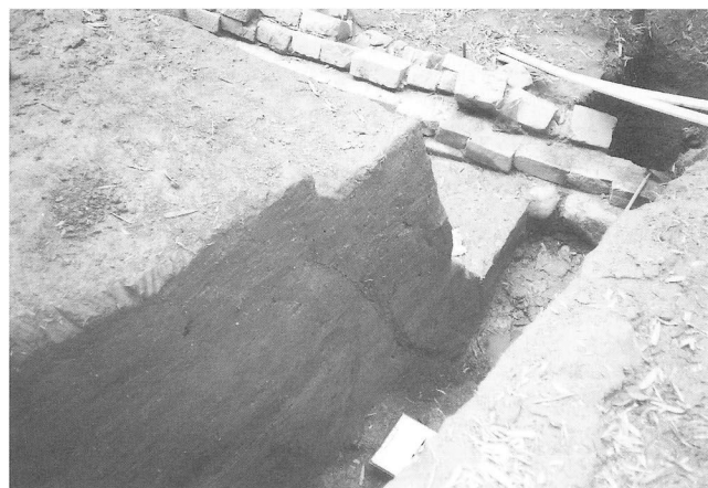
写真9 酒船石遺跡の石垣の崩壊跡 石垣が崩壊し、背後には地割れが生じている。
