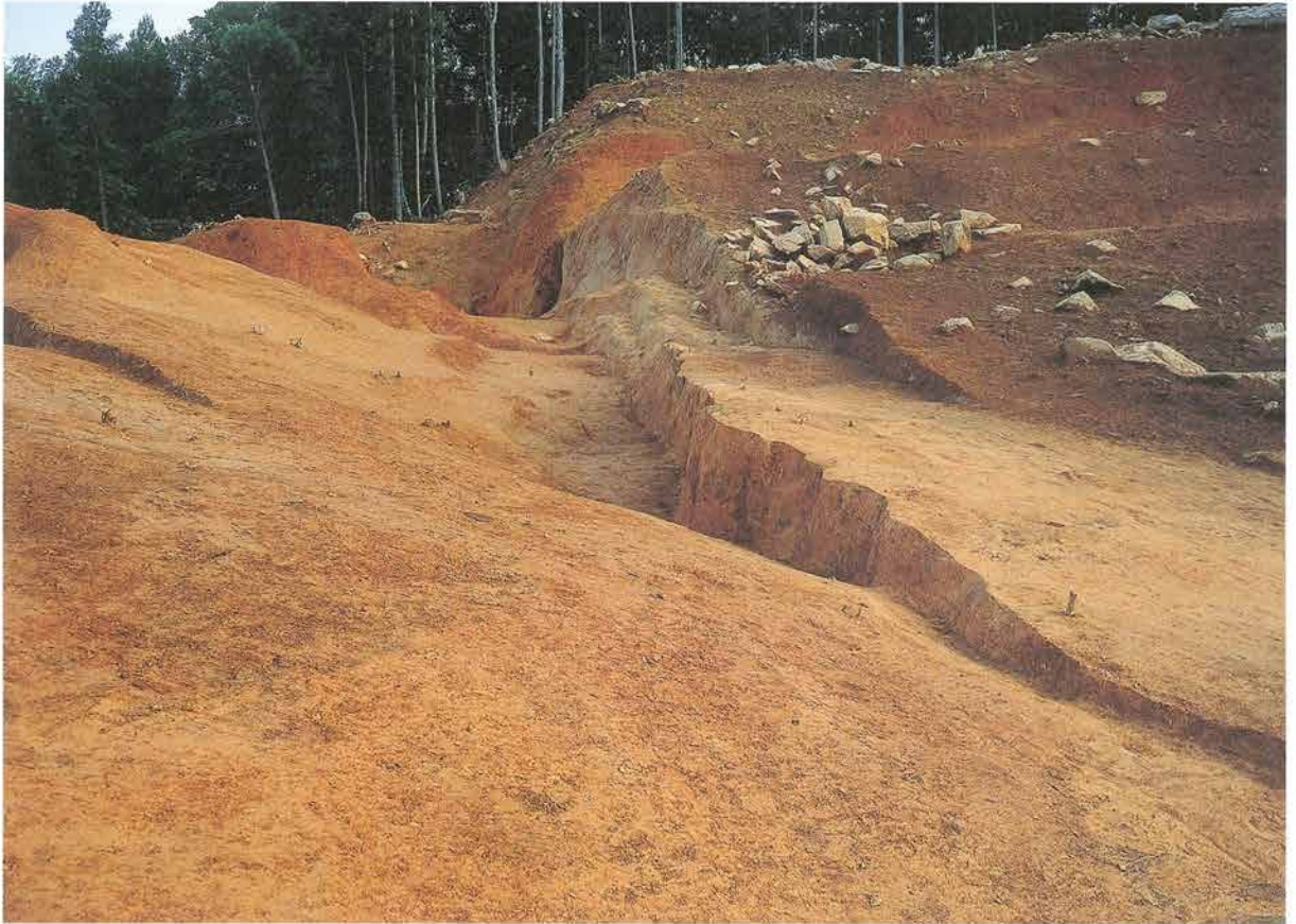
若水城跡 東部地すべりによる段差（北西から）
