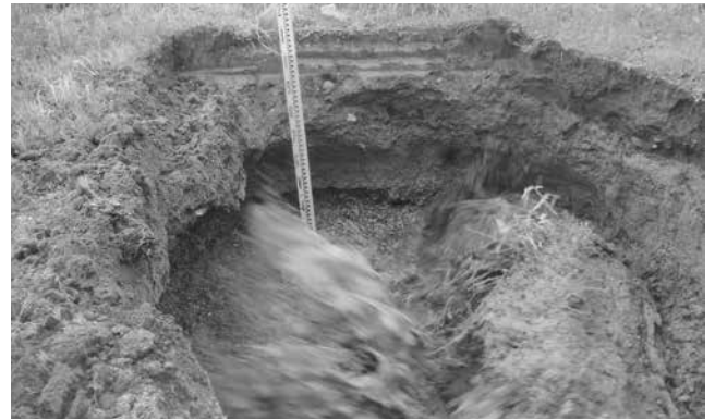
出水によるトレンチの崩落 (表 1 ㉑)
