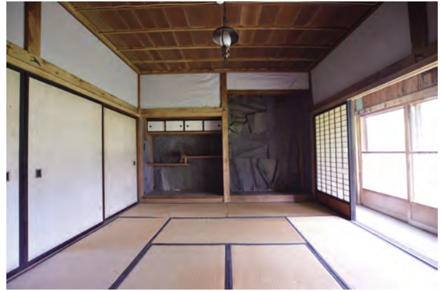
【修理前】客室 5 南よりみる
