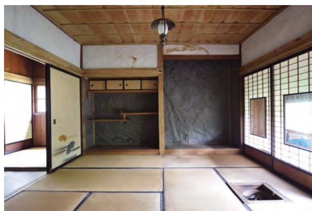
【修理前】客室8 南よりみる
