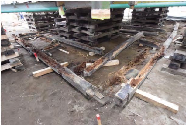
写 3-1-6 土台 (裏面) の腐朽 (北棟)
