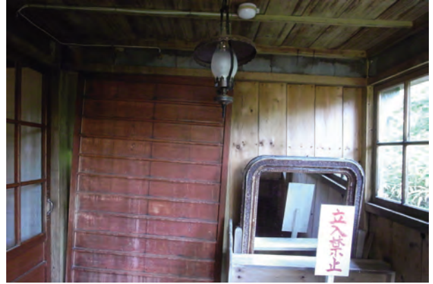
写 3-1-2 床の不陸 (北棟便所)
