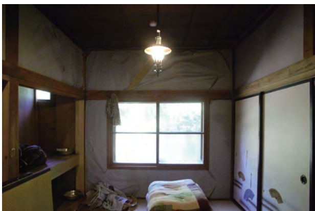
写 3-1-14 雨漏りによる壁面汚損 (客室 3)
