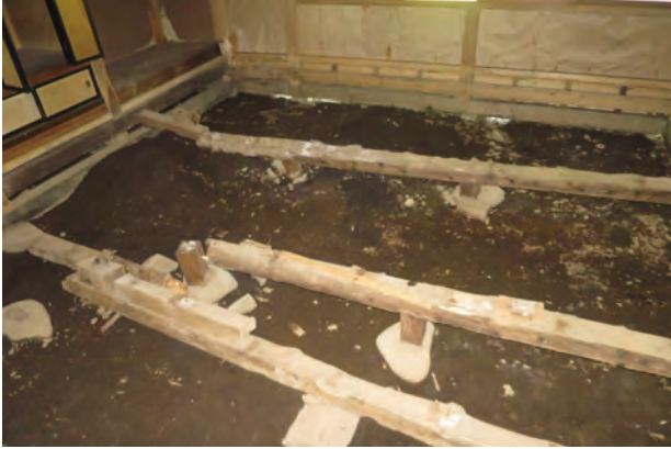
写 3-1-5 大引の腐朽折損 (仏間)
