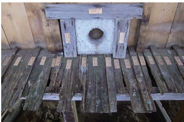
写 3-1-10 板底の破損 (北棟)
