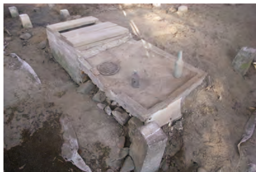
床組撤去後の洗い場（手前）とムロの開口部（南西よりみる）
