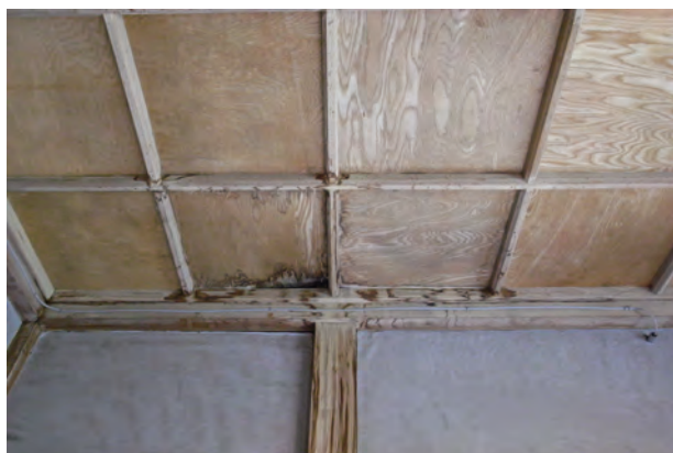
写 3-1-15 雨漏りによる天井面汚損 (事務室)
