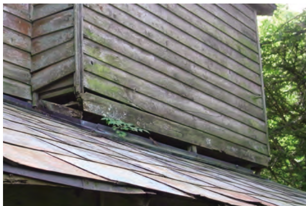
写 3-1-9 北棟下見板の破損 (北棟)
