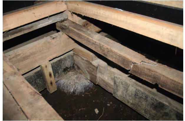
写 3-1-4 根太の腐朽折損 (茶の間)
