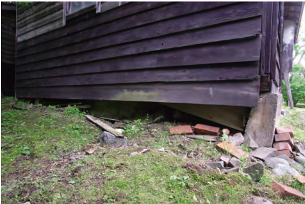
写 3-1-3 基礎の倒れ (南棟)
