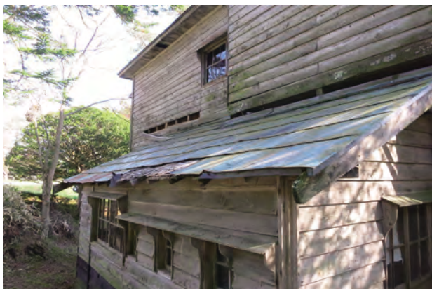
写 3-1-8 軒先の破損 (北棟便所)
