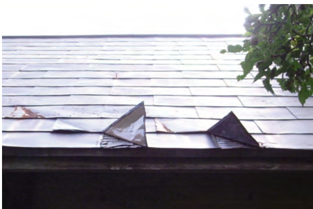
写 3-1-12 屋根鉄板の破損 (中央棟)
