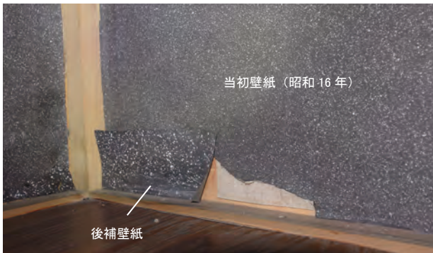
写3-5-40 仏間トコ壁紙の補修痕 仏間トコ壁紙の補修には「北棟」の後補材と同じ紙が用いられる。
