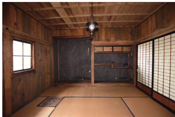
【修理前】客室7 南よりみる
