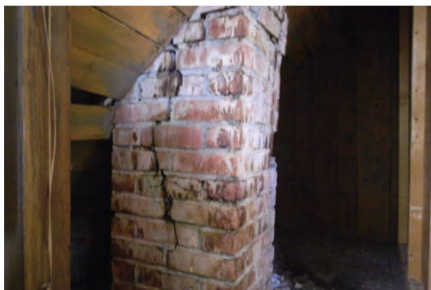
写 3-1-13 煉瓦煙突の割損 (南棟二階)
