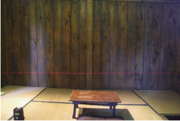
写 3-1-1 床の不陸 (客室 6)
