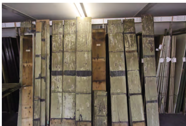
既存塗膜剥離状況 台所化粧板
