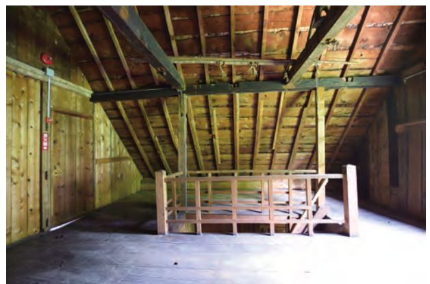
【修理前】小屋裏物置 北よりみる
