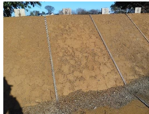
写真8 亀裂発生状態
