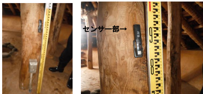
写真5 温湿度データロガー設置状態
