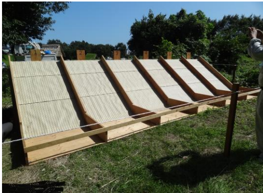
写真 1 屋根下葺材敷設段階 防水シート重ね幅 30cm、突起列は天地方向
