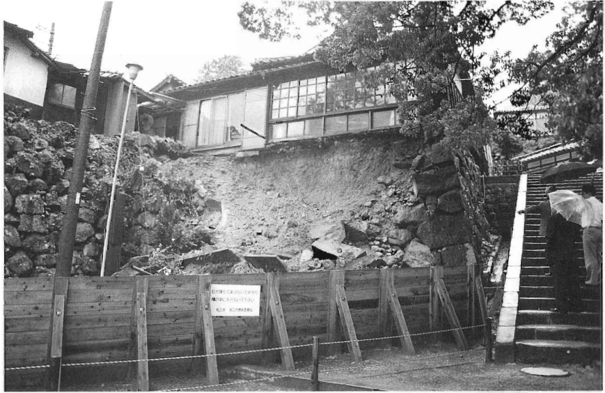
石垣崩壊状況近景（B面）
