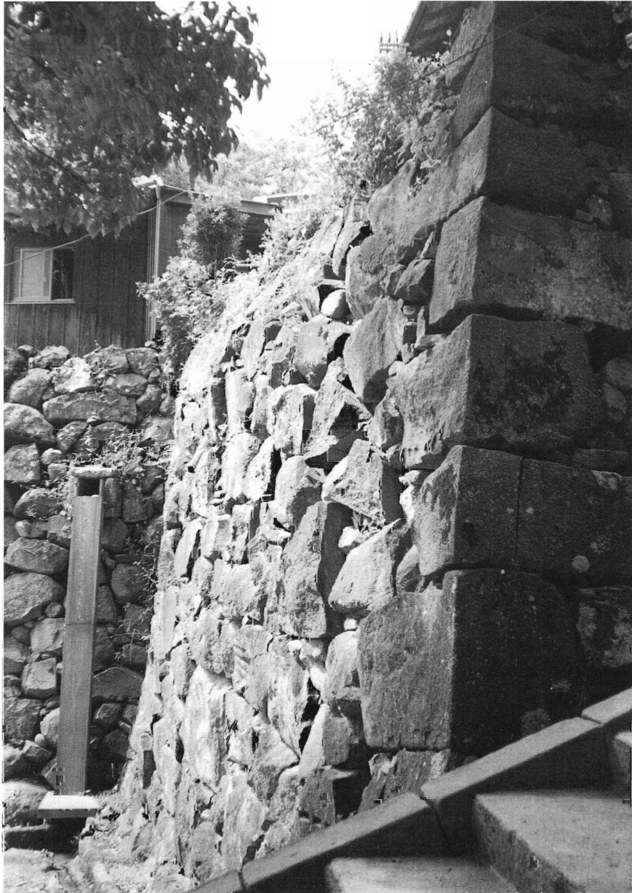
石垣修理前（B面）近景（崩壊前）
