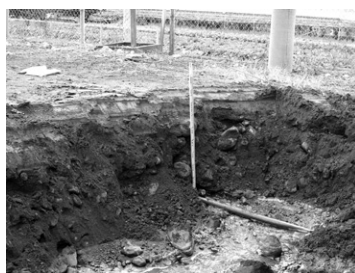
破損した水道管
