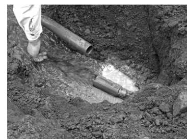
破損した水道管
