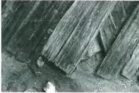
3 橋梁2 板材下端部の小孔
