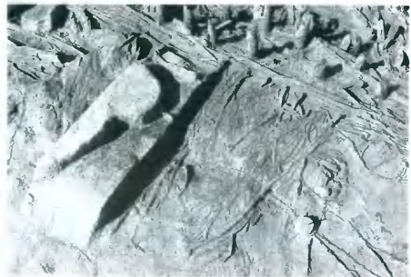
3 堤防中央部 盛土内の枝葉 (東から)
