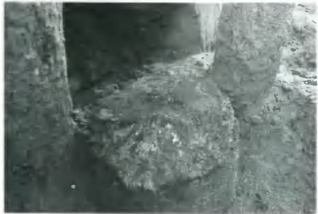
2 橋梁2 橋脚の切断痕跡
