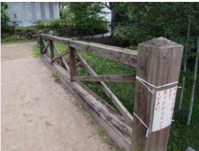
⑥ 木橋の劣化
