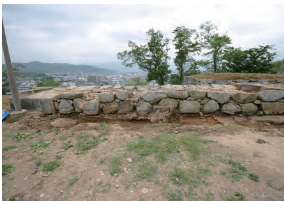
多門櫓腰石垣修理前（南から）
