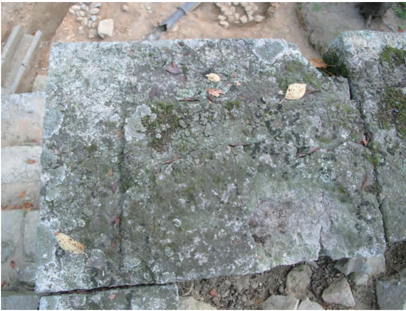
2. 調査区1 天端石の剥り 込み拡大 (西から)
