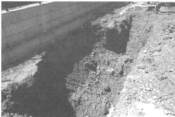
1区南壁崩落状況
