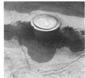
図30 S X-100外蓋除去状況 (北東より)
