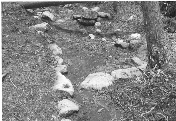
⑤E区排水溝
