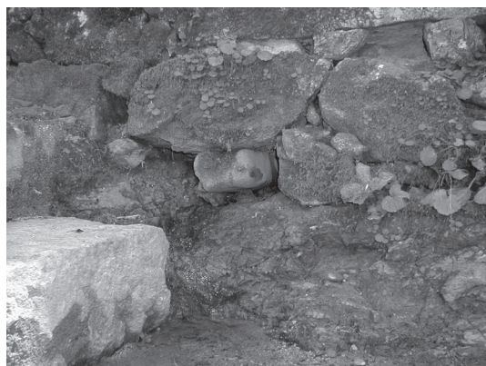
第1図 裏中門南櫓形南石垣の湧水状況
