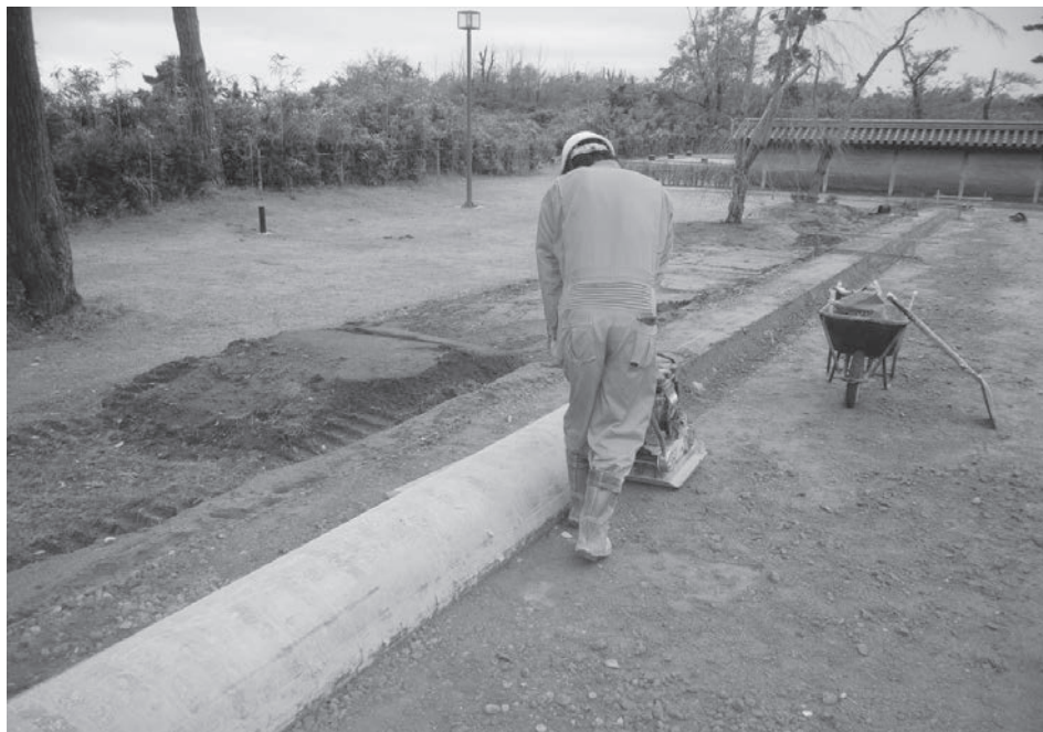
側溝部路盤（砕石）敷均し（東から） 土側溝となる部分の丸みについては 側溝と同じ丸みの厚紙でできた型枠 を利用した。
