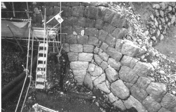
第19図 E面基部 II期石垣をIII期石垣の基部に 利用している状況（東から）
