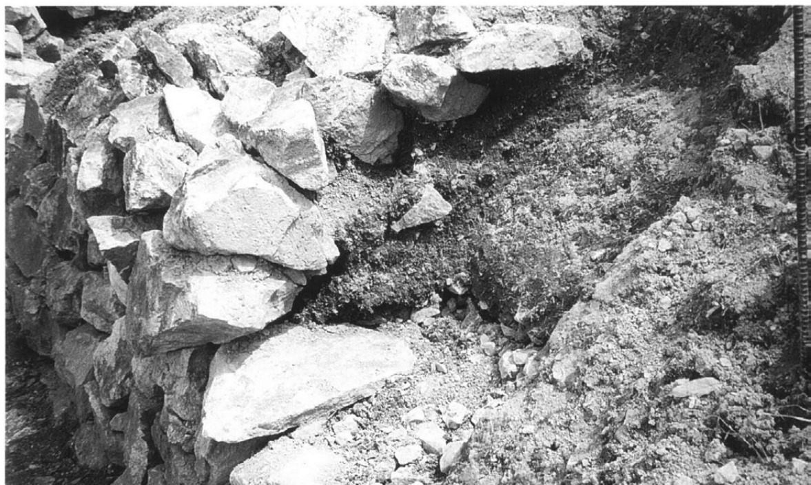
後円部北側裾石垣 丁張りNo.17付近断面 流失した土が裏込に堆積
