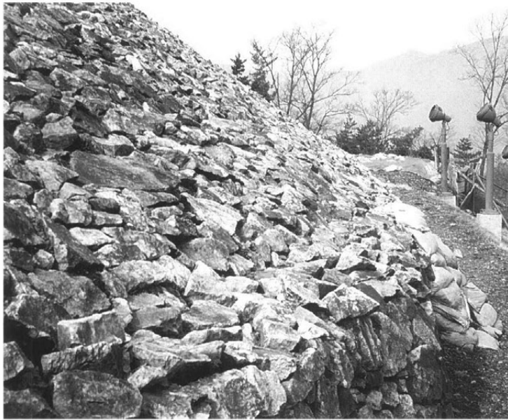
後円部北側 丁張りNo.16～17付近 勾配変換点上部の葺石が大きく陥没し、裾石垣が崩落した
