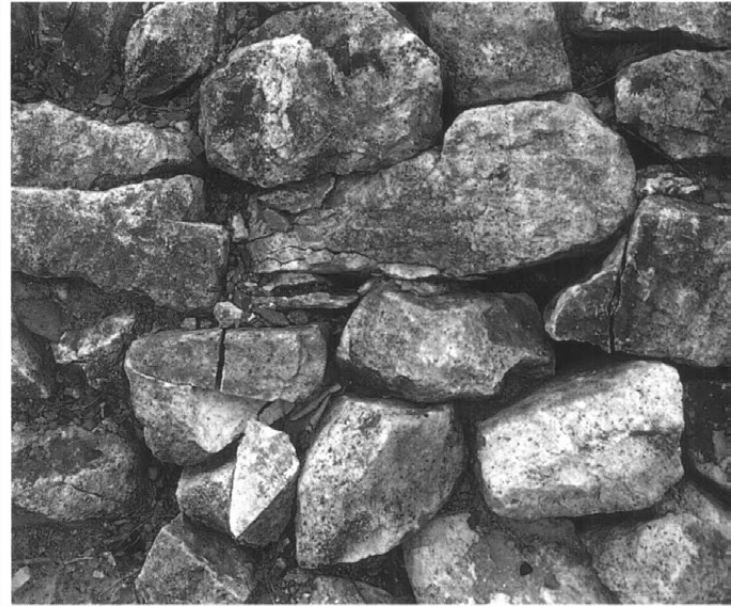
後円部北側墳丘斜面 葺石材が風化や変動によって破損している
