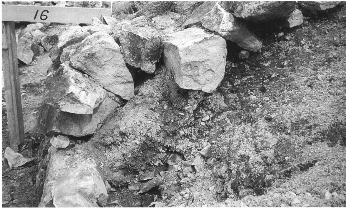
後円部北側裾石垣 丁張りNo.16付近断面 大きな隙間ができている
