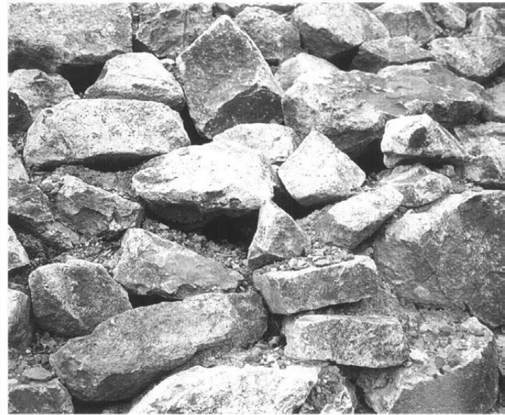
後円部北側墳丘斜面 葦石下地土が流失し、大きな隙間がいたるところにできている
