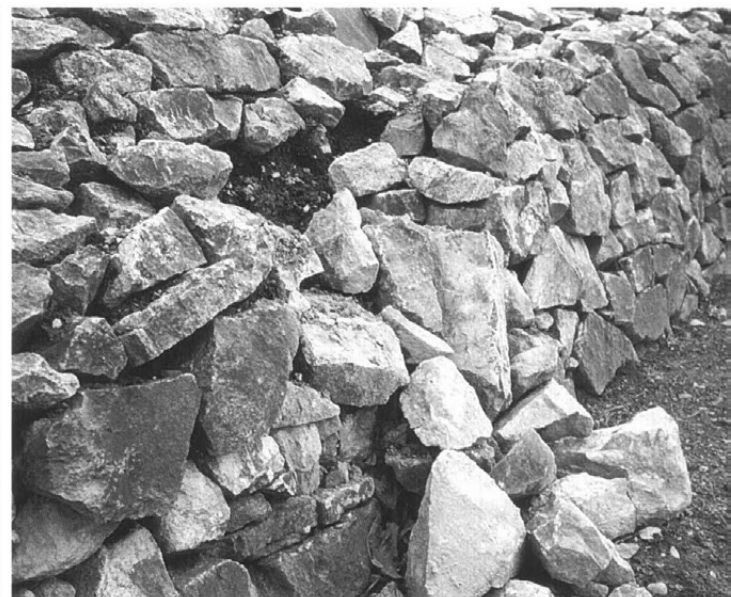
後円部北側裾石垣 平成10年3月下旬、裾石垣崩落発生
