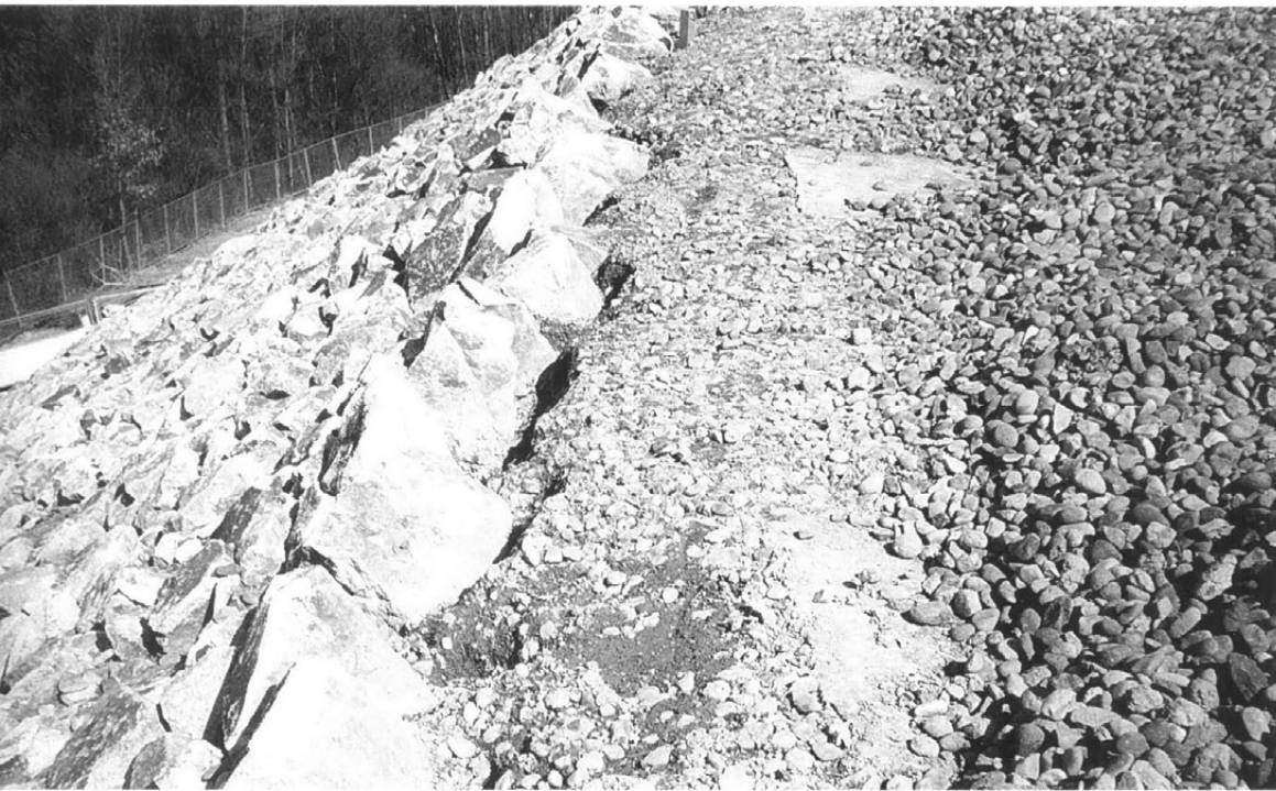
後円部北側上段テラス 丁張りNo.17～18の間 石材がずり落ちている
