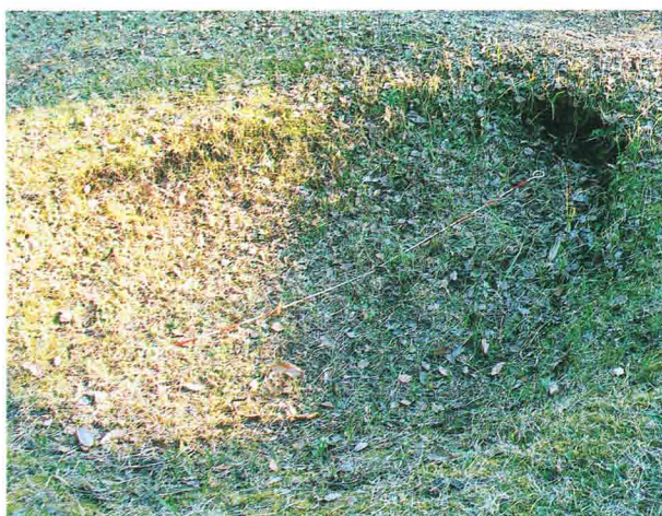
図版16 調査前陥没状況（その2）
