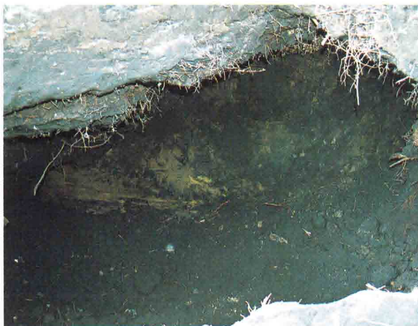
図版22 陥没内壁面状況
